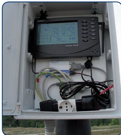
Particolare della centralina Foto di Luca Lombroso
