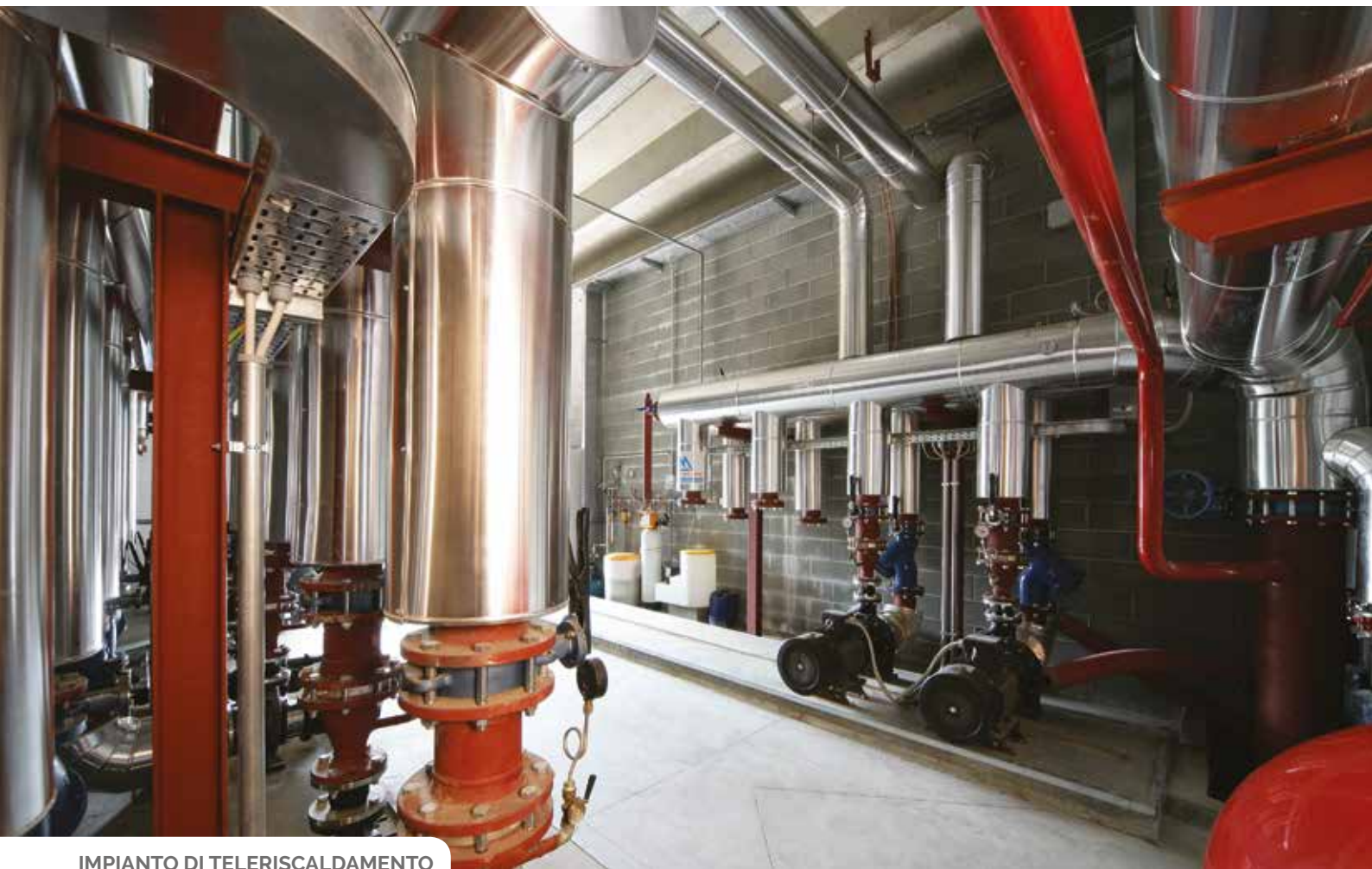
IMPIANTO DI TELERISCALDAMENTO
