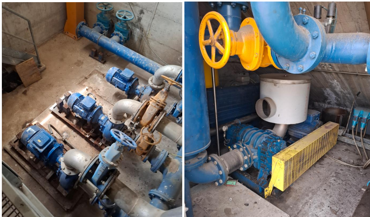
Unità 4: dettaglio batteria pompe di sollevamento (sx); soffiante dedicata al processo di dissabbiatura (dx)
