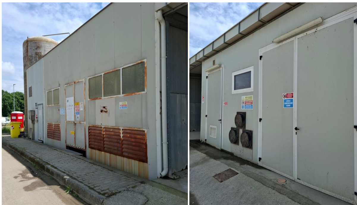
Unità 22: impianto di ozonizzazione, dettaglio locale trattamento ozono (sx) e locale compressori (dx)
