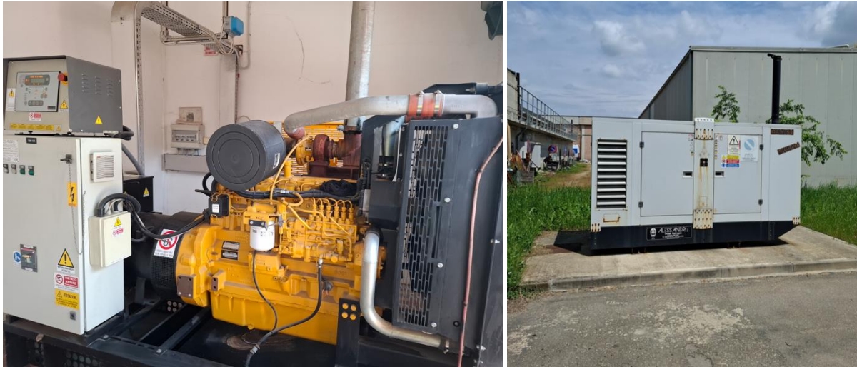
Gruppo elettrogeno principale nell'unità 14 (sx); gruppo elettrogeno secondario a servizio acquedotto (dx)
