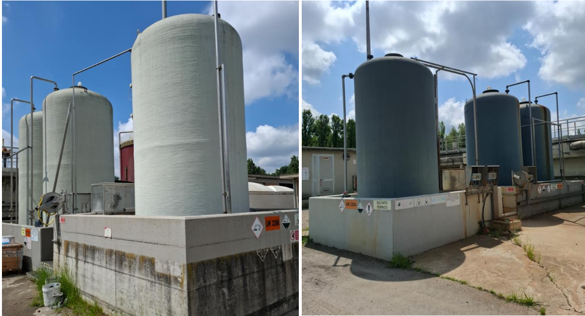
Parchi serbatoi con bacino di contenimento: Alluminato Sodico (sx) e Solfato Ferrico (dx)
